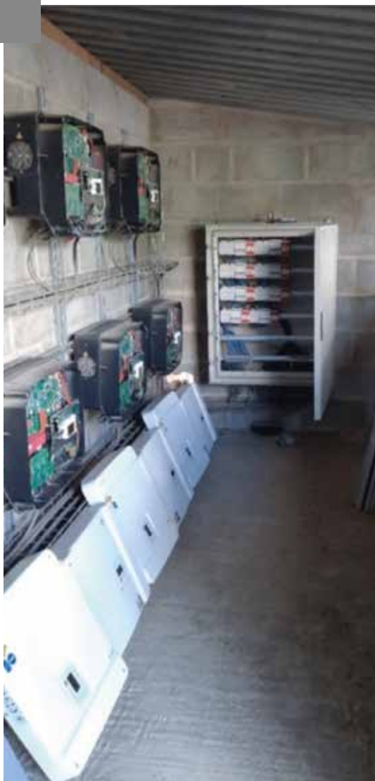
Onduleurs en cours de contrôle par la société de maintenance.
