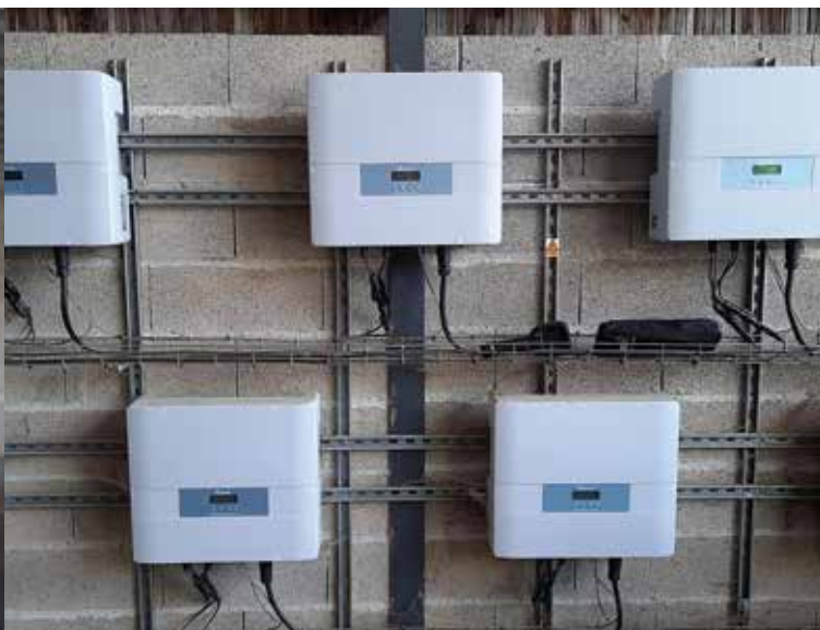
Onduleurs d'une installation.
